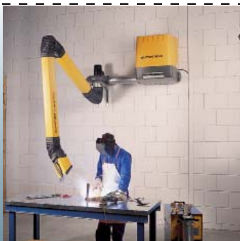
SFD cu filtru mecanic
